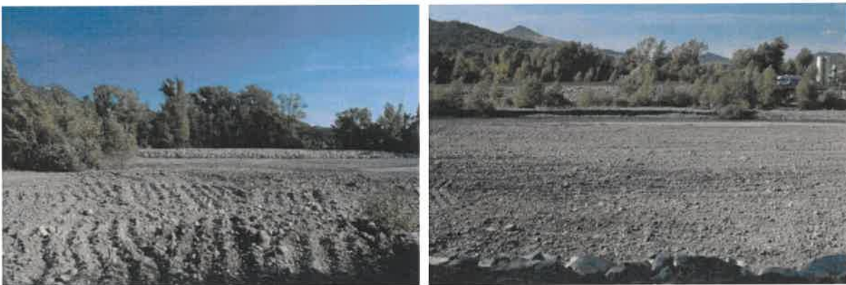
Lit de la Bléone remis en état suite au chantier de confortement de berge au lieu-dit Valadier à Digne (SYNDICAT MIXTE ASSE BLÉONE, 2012)
